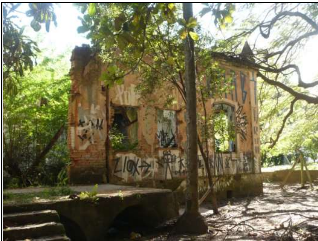
Imagem 34. Depredação e pichação de parte do conjunto do imóvel. Foto: Sueli Herculiani, 2012.
