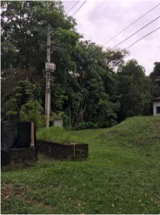
VISTA DO POSTE COM O TRANSFORMADOR ONDE SERÁ LIGADO O GERADOR, AO LADO DIREITO DO POSTE, ÁREA DE INSTALAÇÃO DO GERADOR
