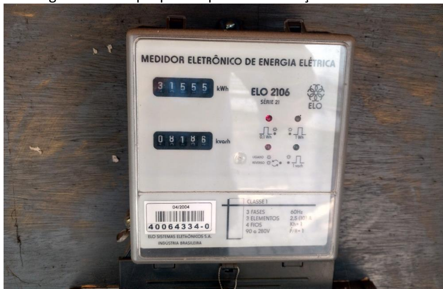
Figura 3.6 – Medidor de energia DEINTER 9
