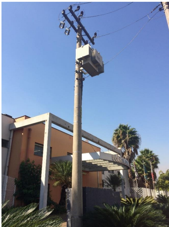
Figura 3.4 – Entrada geral de energia DEINTER 9
