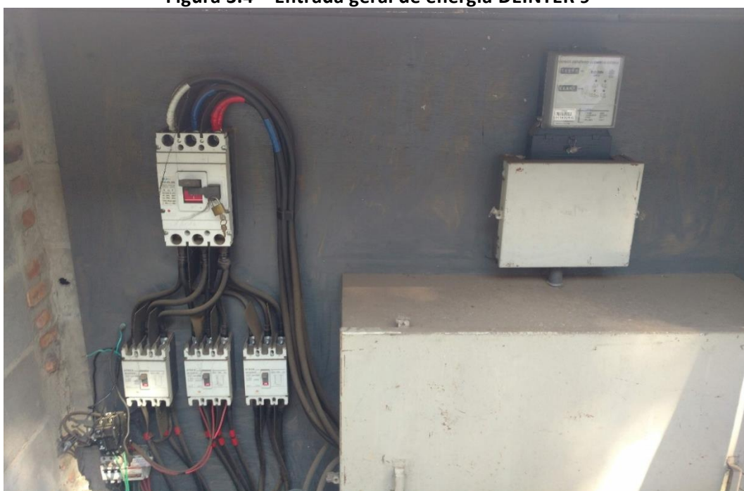
Figura 3.5 – Dispositivo de proteção da entrada de energia
